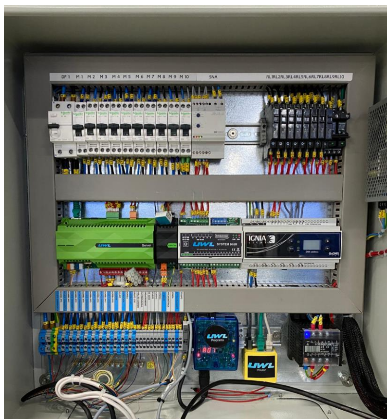
Elements de control quadre elèctric realitzat per Urban Wet Lines
